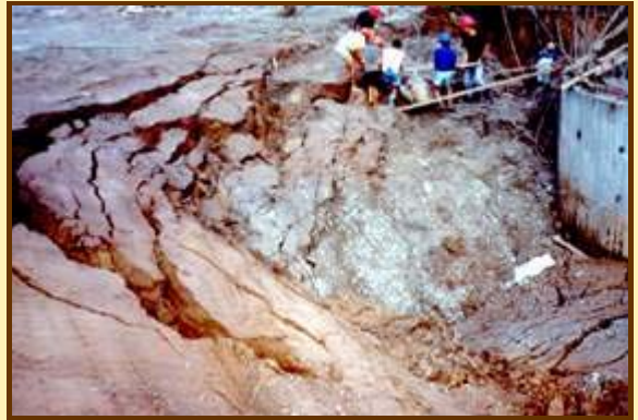
Foto-2 Asentamiento por fenómeno de tubificación al interior del cajón .
