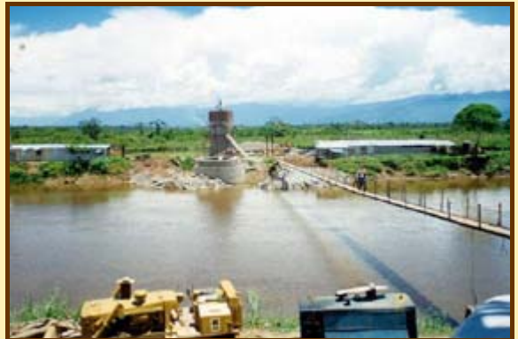
Foto-3. Cajones del puente, Pilar y Estribo que no pueden hincarse .
