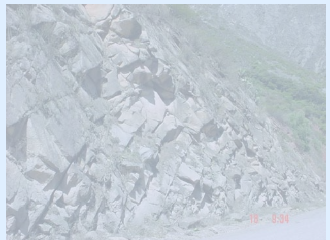
Foto-1: Talud de Carretera Chalhuanca-Abancay. Que muestra el macizo rocoso fracturado y alterado.
