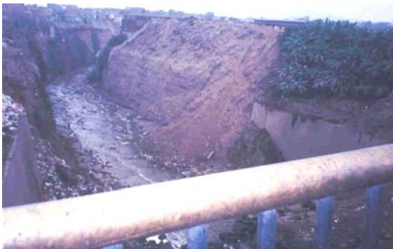
FOTO-4: PROFUNDIDAD DE LA SOCAVACIÓN DEL CAUCE 20m, Y DERRUMBE EN RELLENO. PUENTE DEL EJERCITO (Foto-F.H.G-2003),
