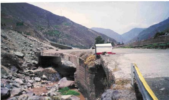
FOTO-3: VISTA DE LA CONSTRUCCIÓN DE PONTONES QUE OCASIONAN LA REDUCCIÓN DEL ANCHO DEL CAUCE . MATUCANA – 1995.(Foto-F.H. G)
